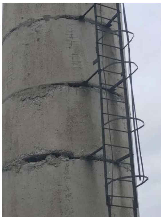
Дефекты швов между сборными ж/б элементами, требующие ремонта
