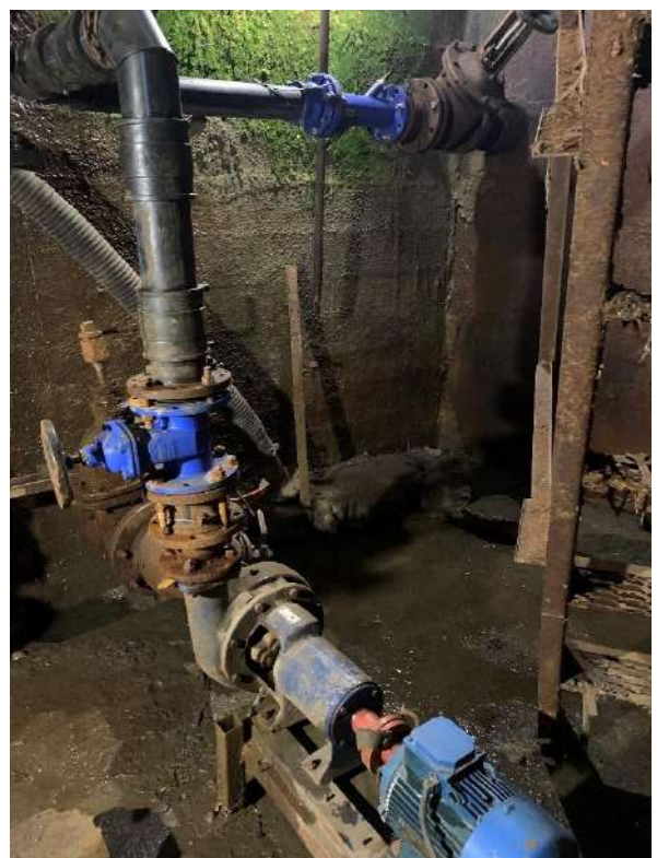
Рабочий насосный агрегат насосного агрегата в КНС
