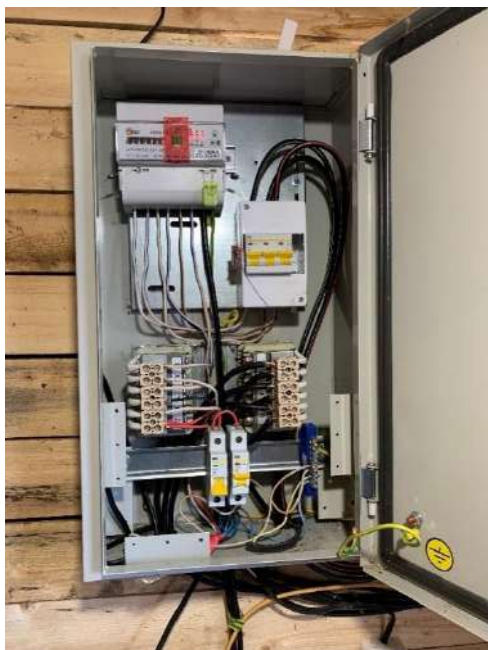
Узел учета электроэнергии
