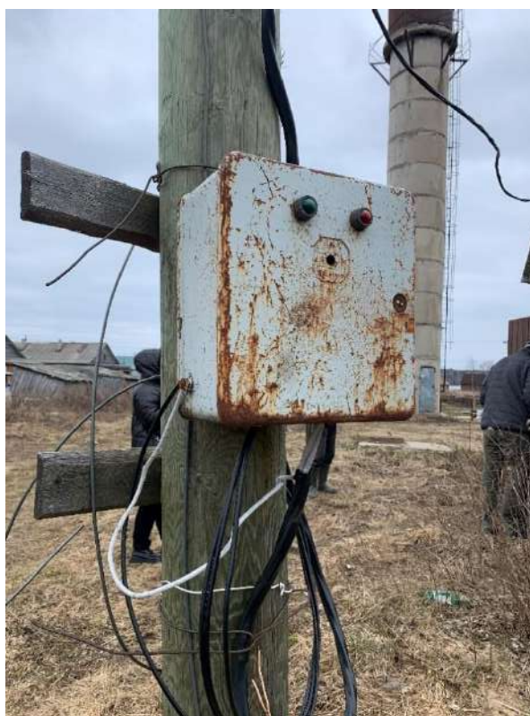
Наружный щит подключения
