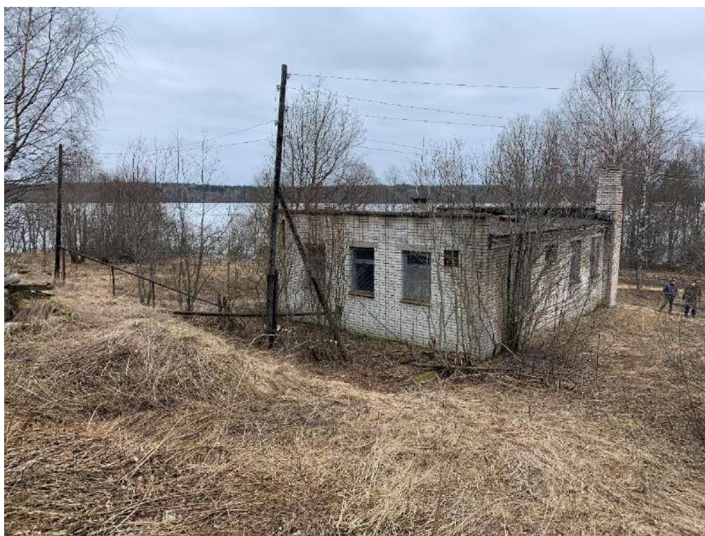
Производственное вспомогательное здание, 9м x 12м x 3м(н) - с неработающим оборудованием: воздуходувной станции, котельной, электролизной, с бытовыми помещениями персонала, с душевой, туалетом и раковиной
