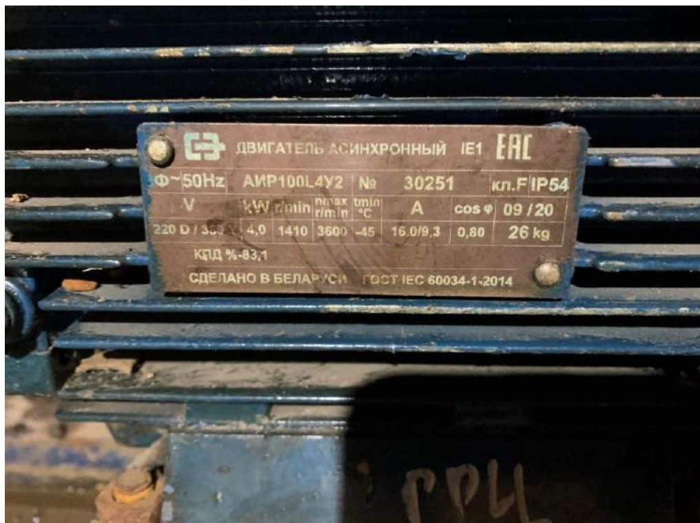
Шильда электродвигателя насосного агрегата
