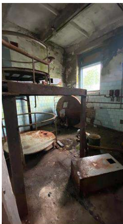
Состояние помещений и оборудования вспомогательного здания КОС
