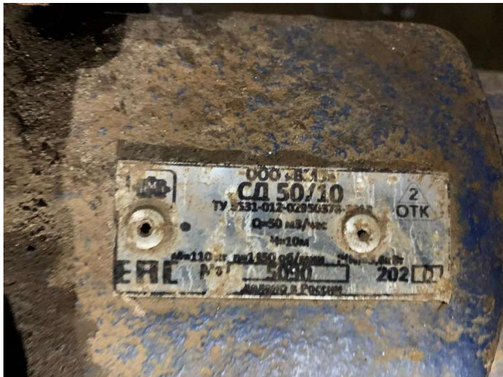
Шильда насосного агрегата
