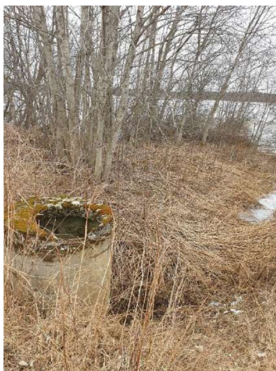
Приемный колодец очищенных стоков перед выпуском в водоём (не работающий)
