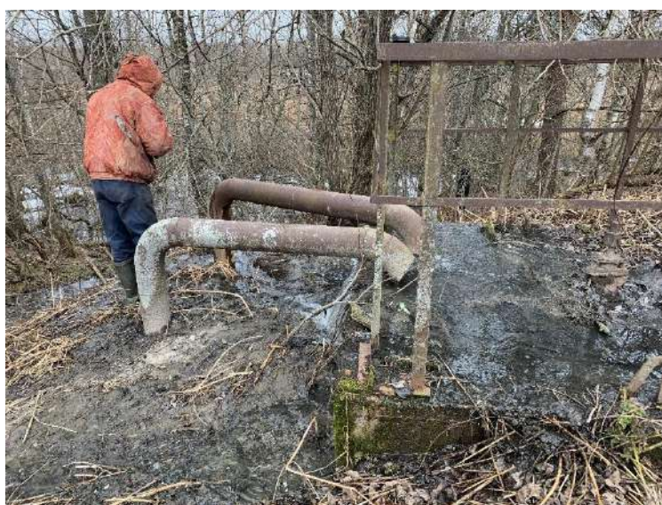
Приемная камера сточных вод КОС
